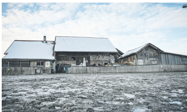
Wohnhaus, Offenstall und Reitplatz der Reitschule Thun bedürfen dringend einer Sanierung.
